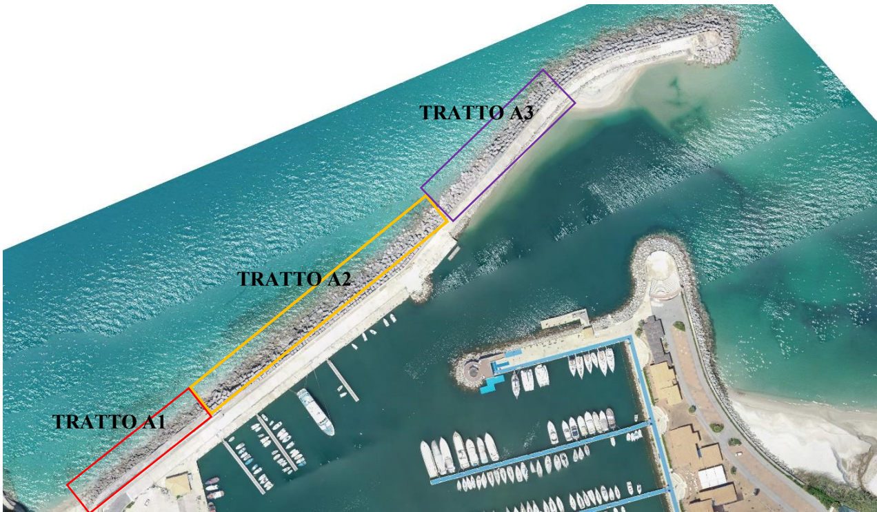
Figura 9: Vista aerea del molo foraneo rilevata dal drone nel marzo 20202, con individuazione dei tratti soggetti a diversi problemi strutturali.
