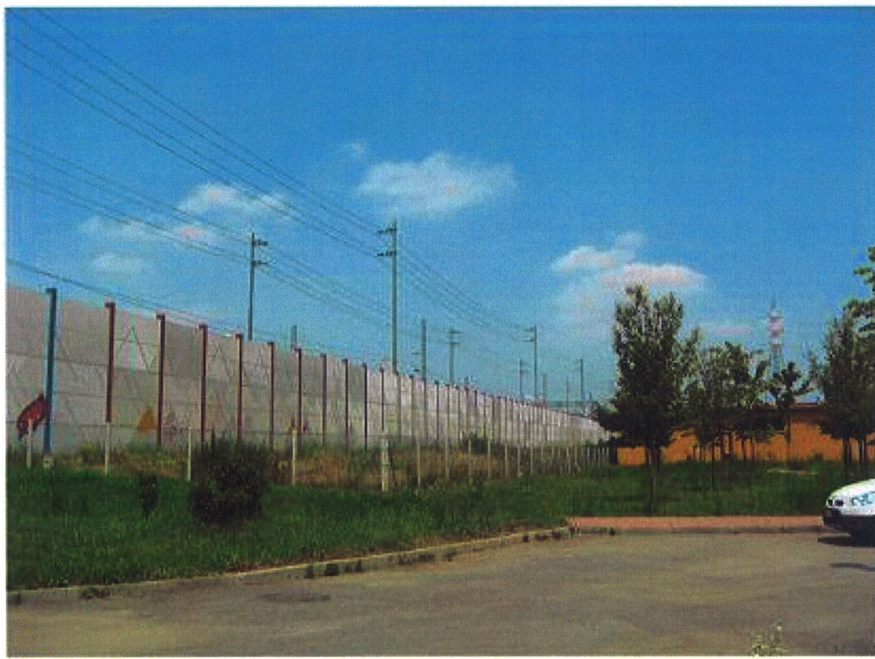
Figura 102 - Stato attuale delle barriere acustiche installate lungo la linea ferroviaria nel comune di Settimo Torinese, direzione ovest.
