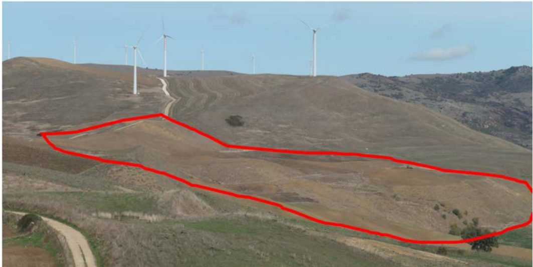
Figura 4-12: Area della recente frana
