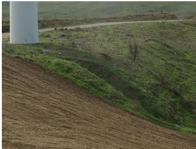
Erosione concentrata al piede della turbina.
