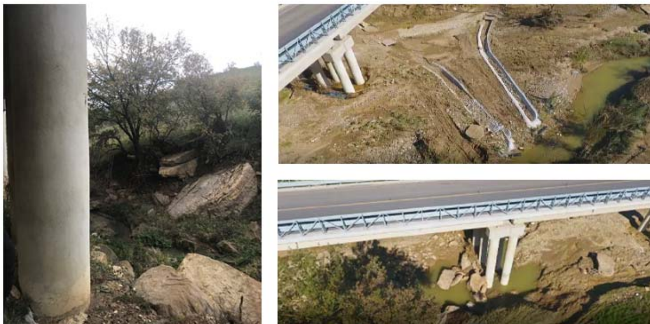
Figura 27 - Danneggiamenti in corrispondenza di VE02 a seguito degli eventi di Novembre 2018
