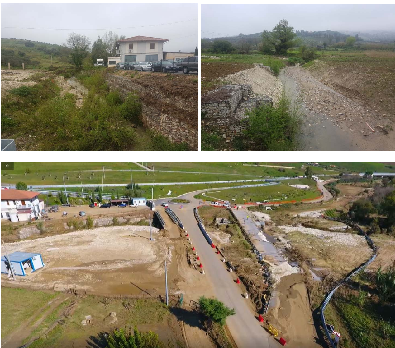
Figura 21 - Danni alla sistemazione fluviale già realizzata ed alle viabilità secondarie e provvisorie
