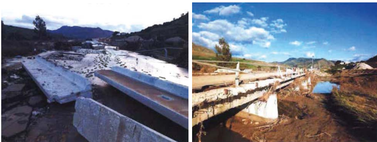
Figura 2 - Danni all'infrastruttura in coincidenza del Viadotto San Leonardo in seguito agli eventi di Novembre 2018
