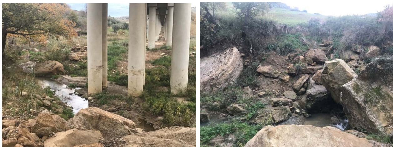
Figura 28 - Condizione attuale del Vallone frattina in prossimità della Pila 2 e fenomeni di dissesto a monte del viadotto
