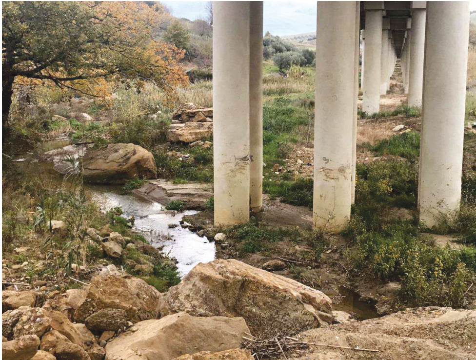
Figura 2: Condizione attuale del Vallone frattina in prossimità della Pila 2 a seguito degli eventi di Novembre 2018
