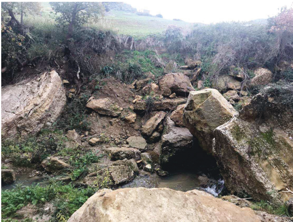
Figura 3 Fenomeni di dissesto a monte del viadotto
