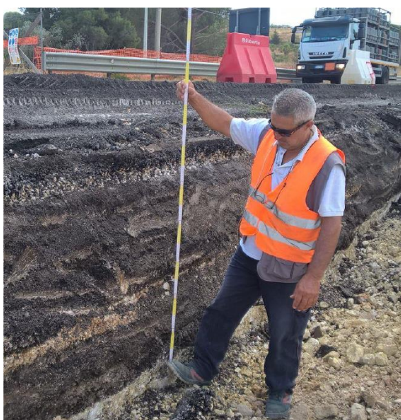
Fig. 4. Sezione stradale n.288 – abnorme spessore di conglomerato bituminoso che testimonia le ripetute ricariche di asfalto eseguite nel tempo.
