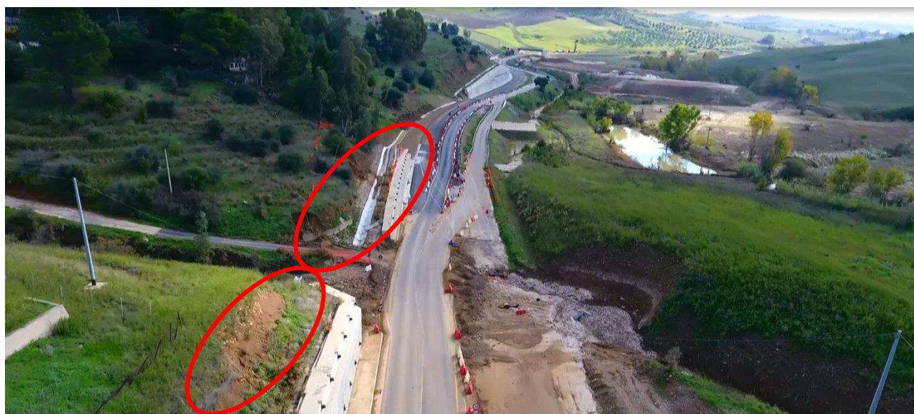
Figura 1- SCOSCENDIMENTI SUPERFICIALI IN SOMMITÀ DELLA PARATIA OS04
