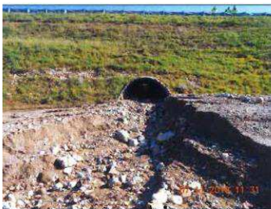
Figura 2 Danneggiamenti inalveazione TP30 a seguito degli eventi di novembre 2018
