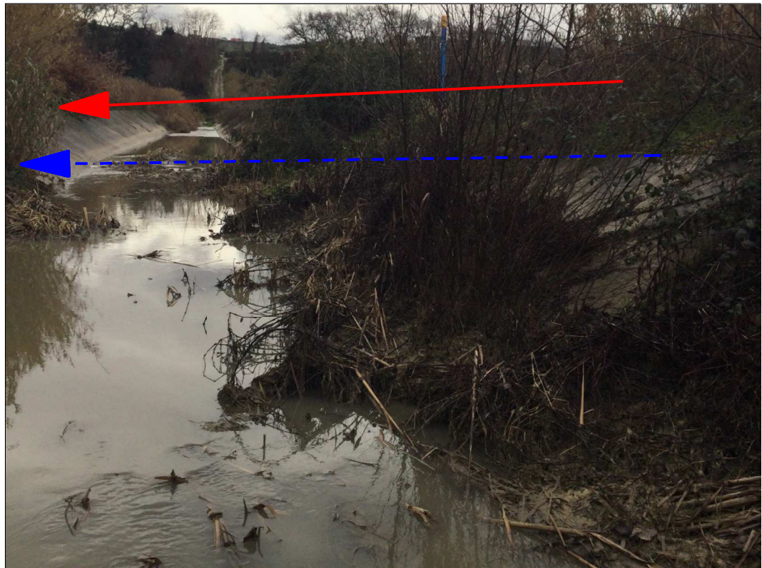
Attraversamento Fosso Bartolone (rivestito in c.a.)
