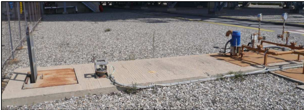
Vasca di raccolta olio trasformatori
