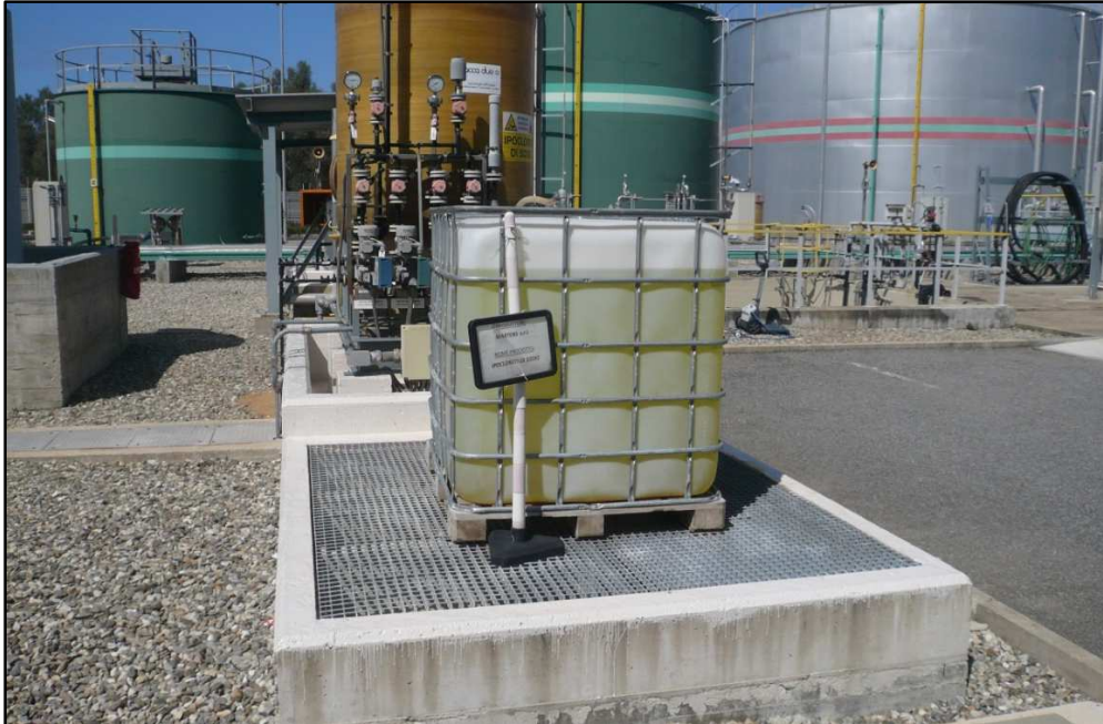
Foto 6.1.4b Stoccaggio Ipoclorito di Sodio
