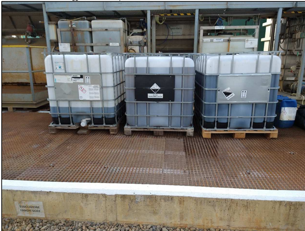
Foto 6.1.4a Stoccaggio chemicals Impianto ZLD / Demi
