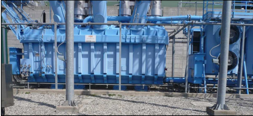
Foto 6.1.2b Aree d'impiego olio dielettrico
