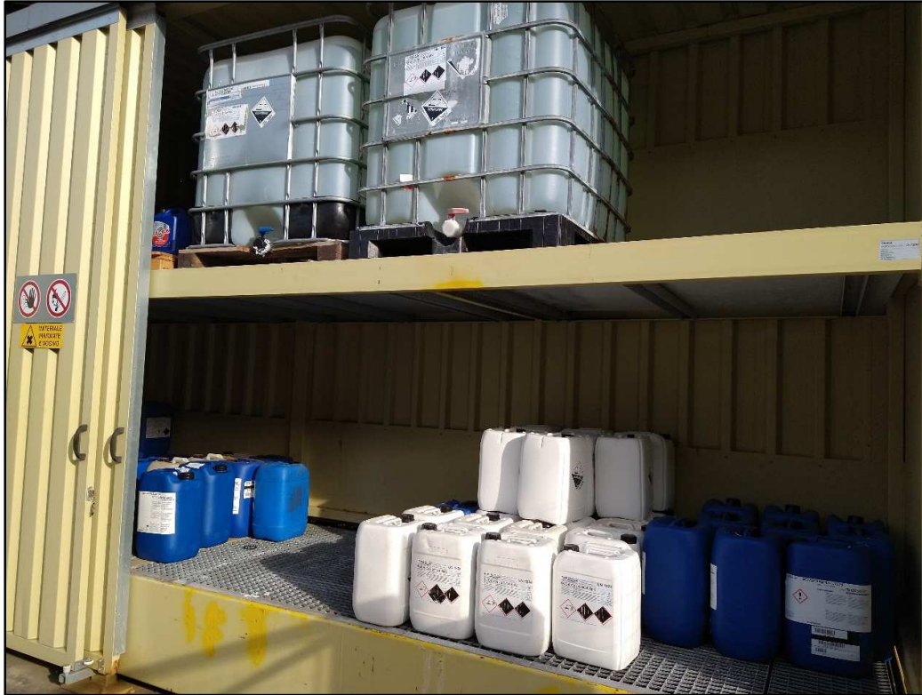
Foto 6.1.5a System container prodotti chimici
