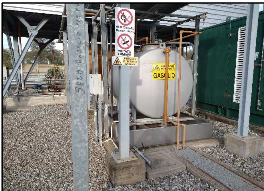
Serbatoio gruppo elettrogeno 3 m 3
