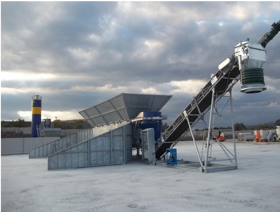
Figura 7: immagine di un impianto di betonaggio semovente in esercizio.
