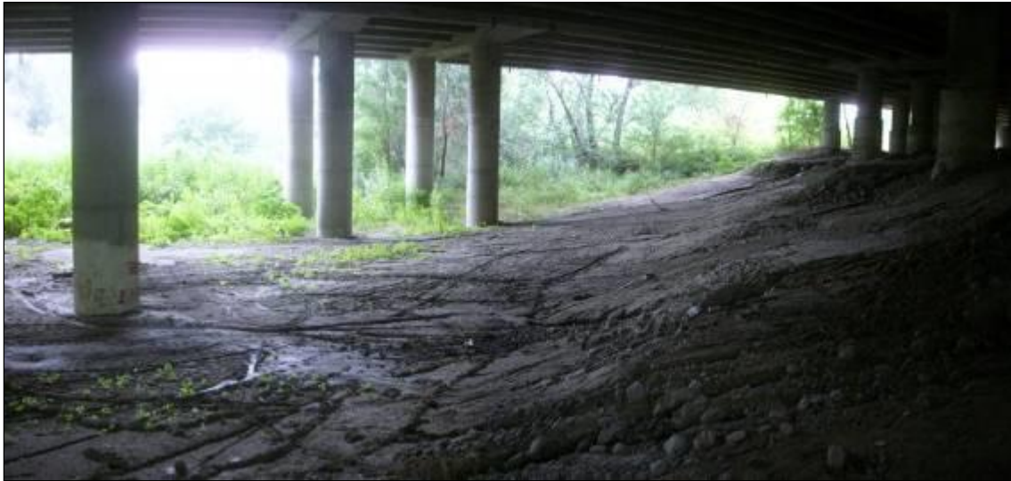
Fig.35 - Alveo attuale del F. Reno: erosioni superficiali attive legate al ruscellamento concentrato; l'acqua proviene dalle banchine del sistema tangenziale in esercizio; a destra della foto si vede il profilo dell'argine idraulico sinistro.
