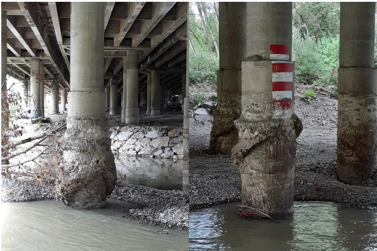
Fig. 34b,c- Scalzamento delle pile in alveo del Viadotto Reno (foto 09/2020).
