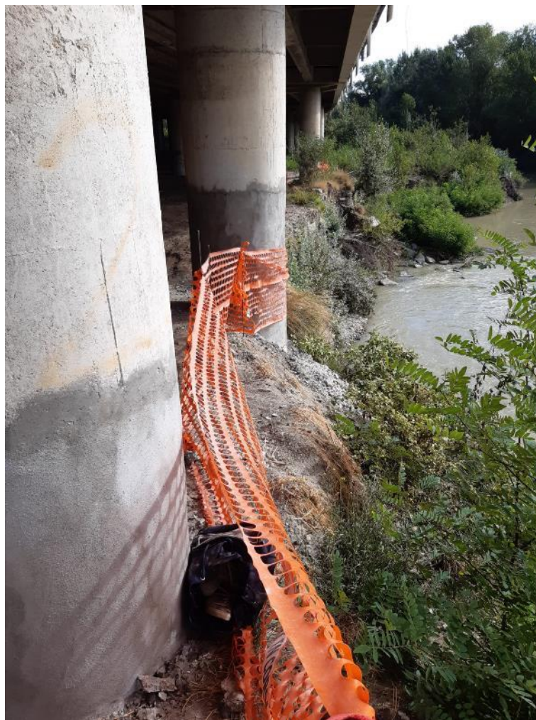
Fig.32b - Alveo attuale del F. Reno (foto 09/2020: particolare dei fenomeni erosivi attivi che arrivano a lambire le fondazioni dell'impalcato della tangenziale.
