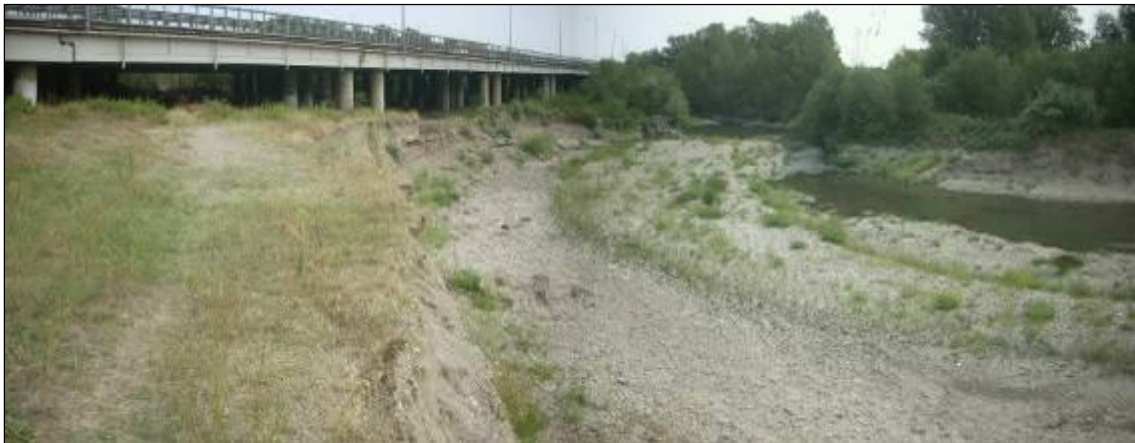
Fig.26 – Alveo attuale del F. Reno (panoramica verso valle del 2016): a sinistra scarpate fluviali di altezza variabile da 3÷5 m ; in secondo piano l'impalcato del sistema tangenziale in esercizio.
