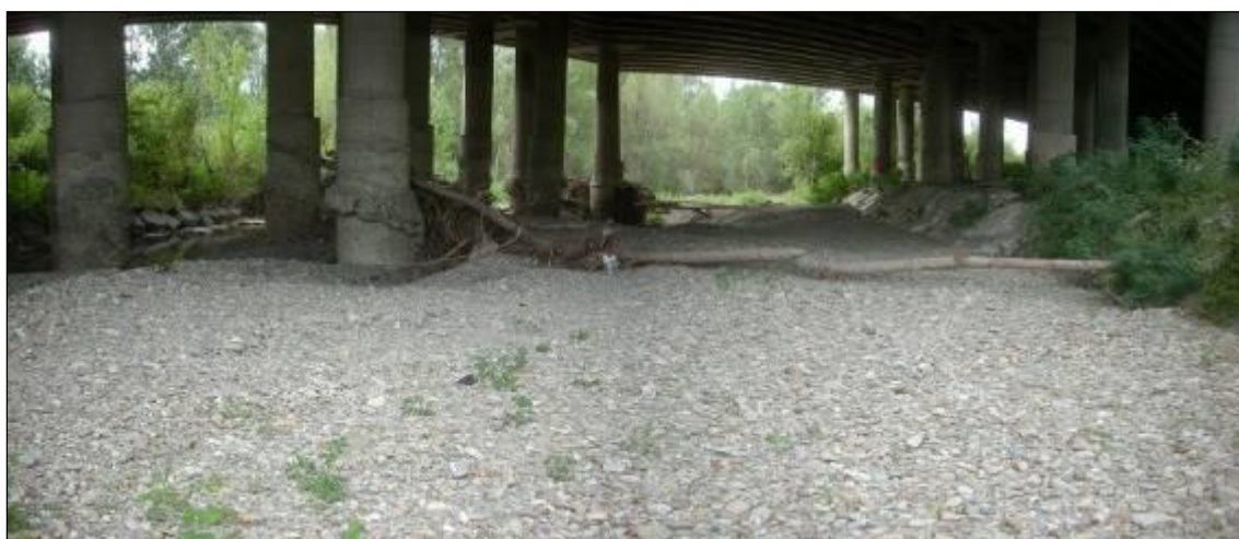
Fig.33 - Alveo del F. Reno panoramica verso monte (foto 2016): depositi alluvionali recenti con uno spessore 1\div 1.5 m; si notano porzioni residuali relative alle opere di protezione sui plinti del sistema tangenziale in esercizio.
