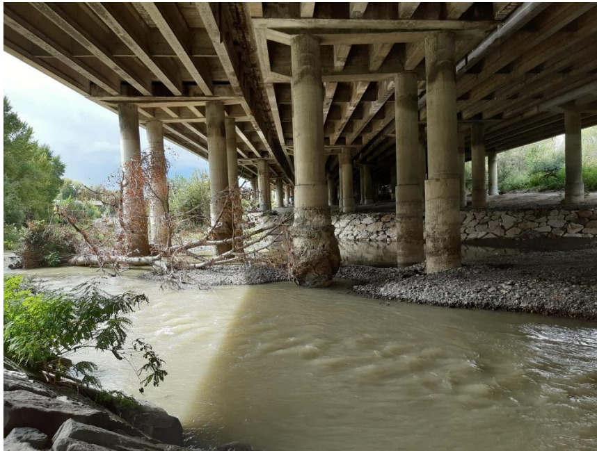
Fig. 34a- Scalzamento delle pile in alveo del Viadotto Reno (foto 09/2020).
