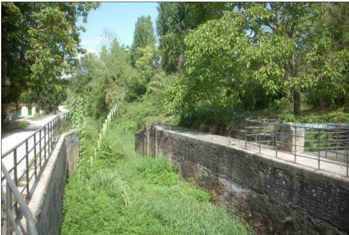
Fig. 43 – Alveo artificiale Canale Navile, particolare delle opere idrauliche e dei rivestimenti delle sponde.
