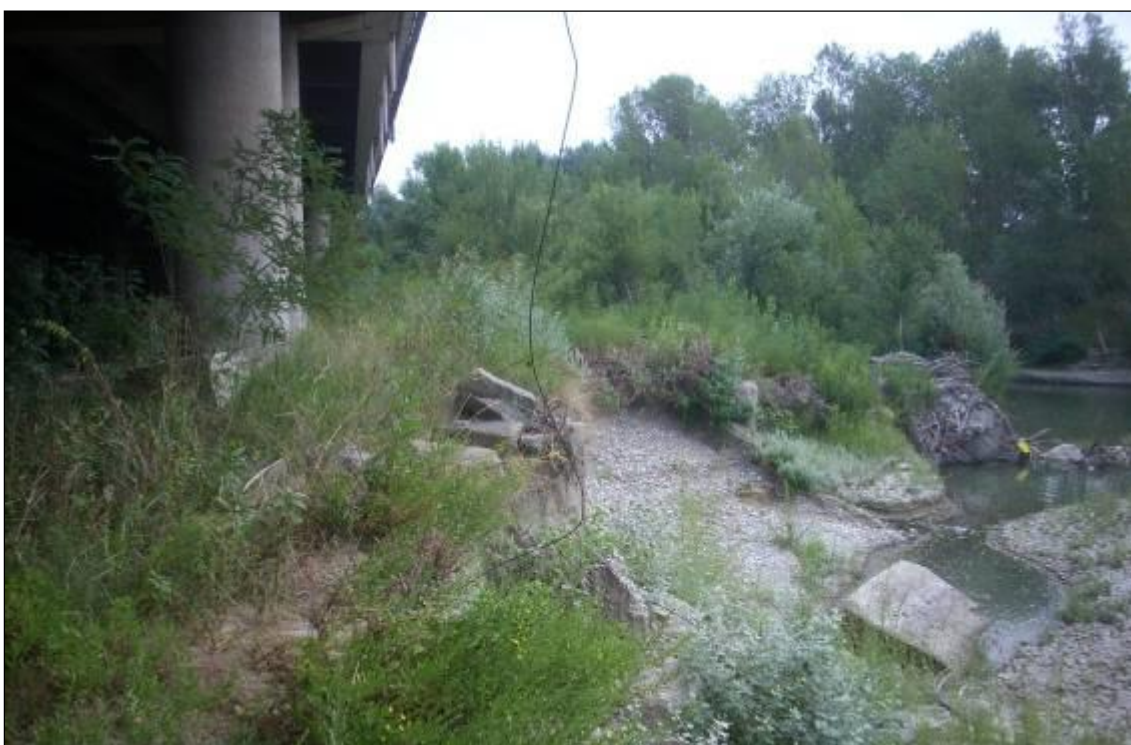
Fig.32a - Alveo attuale del F. Reno (foto 2016): particolare dei fenomeni erosivi molto attivi sulle scarpate e prossimi alle fondazioni dell'impalcato della tangenziale.
