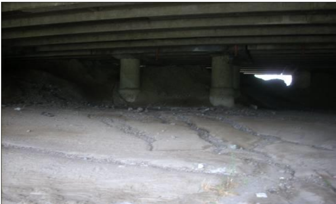
Fig.36 - Alveo attuale del F. Reno: erosioni superficiali attive legate al ruscellamento concentrato; l'acqua proviene dal sistema tangenziale in esercizio; in secondo piano s'intravede il profilo dell'argine idraulico destro.
