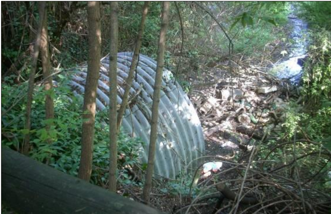
Fig. 41 - Alveo Savena Abbandonato, si noti il tubo corrugato con un diametro di 1.5m per l'attraversamento.
