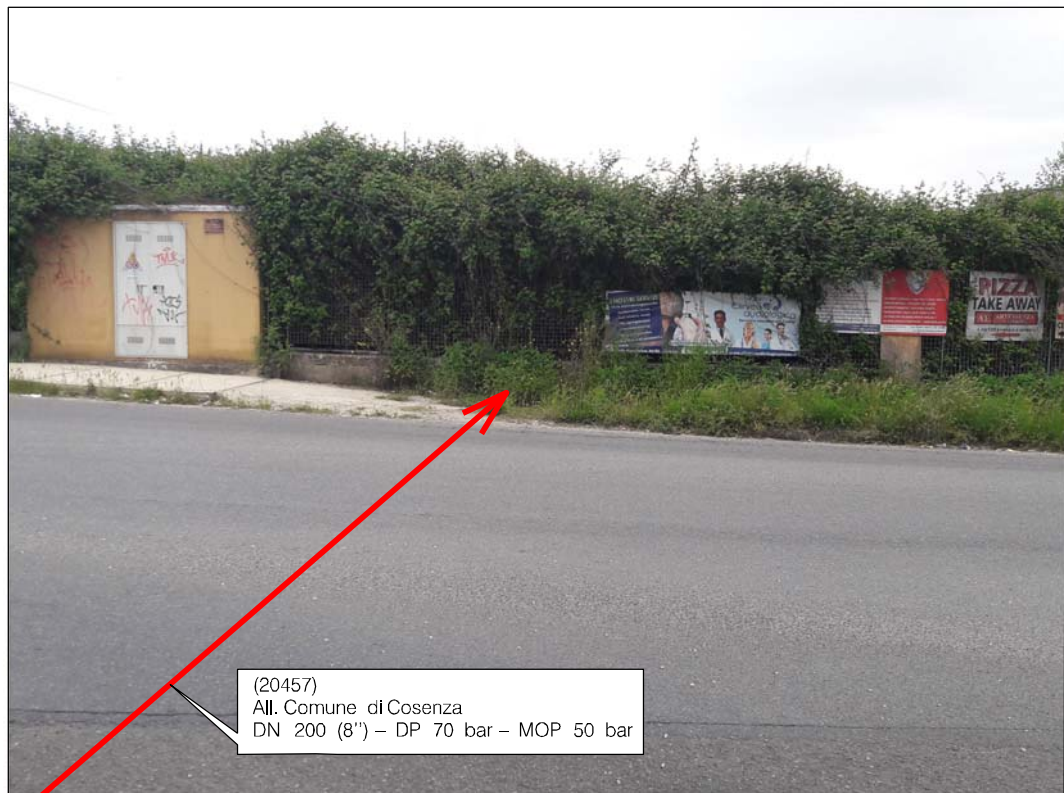
Attraversamento Via Metaponto in prossimita' dell'incrocio con Via degli Stadi nel territorio di Cosenza
