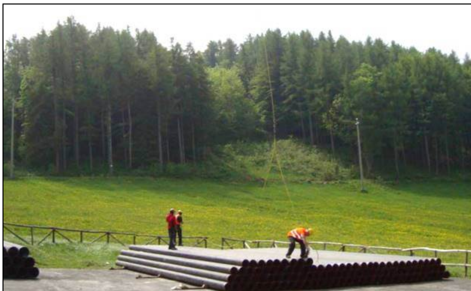
Fig. 9.1/A: Piazzola di accatastamento tubazioni
