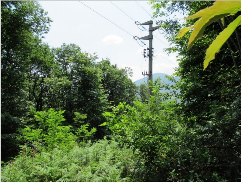
Foto 2.8 Palo della linea a media tensione
