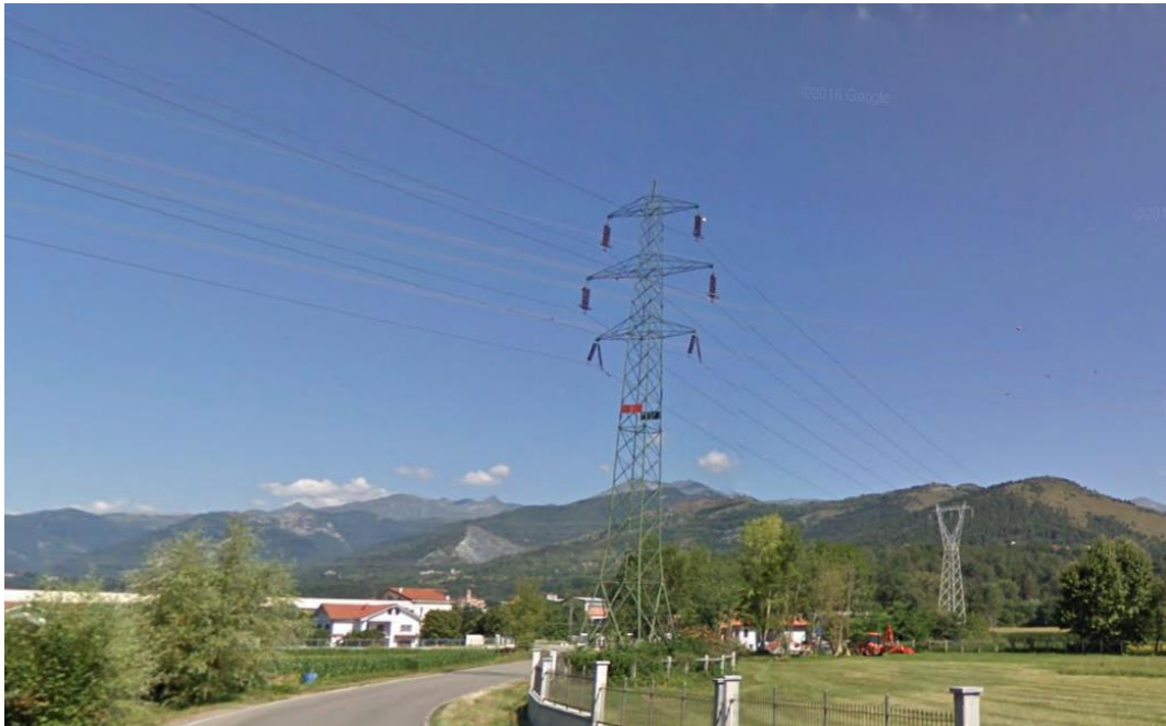
Figura 6.2/9: dominanza visuale della linea di prevista dismissione su via Balangero a Mathi.
