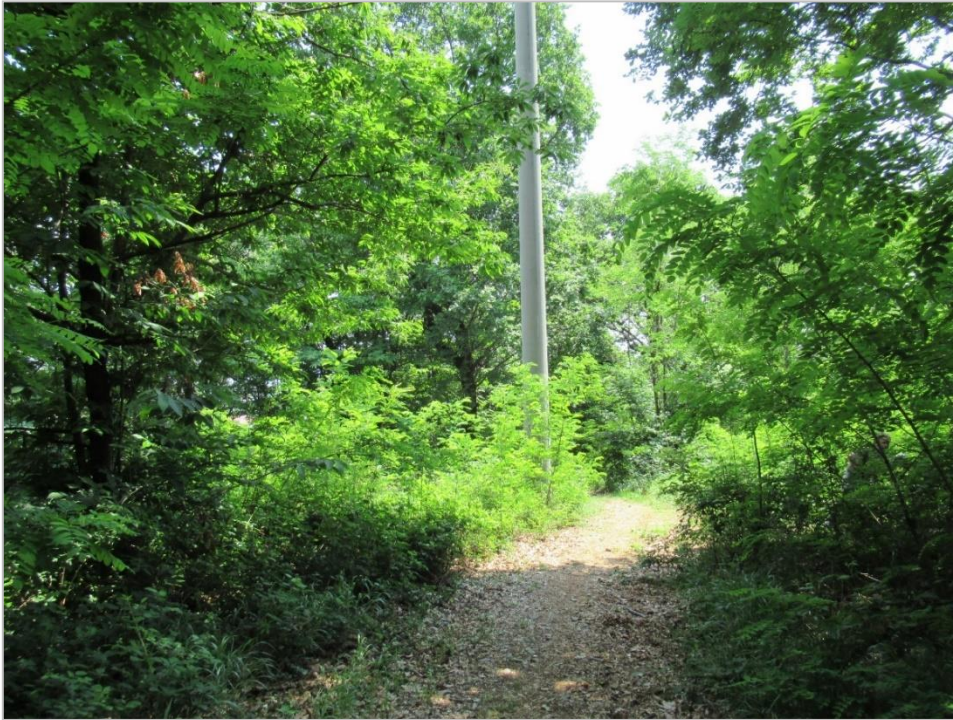
Foto 1.12 Vista della pista in corrispondenza del palo della linea a media tensione
