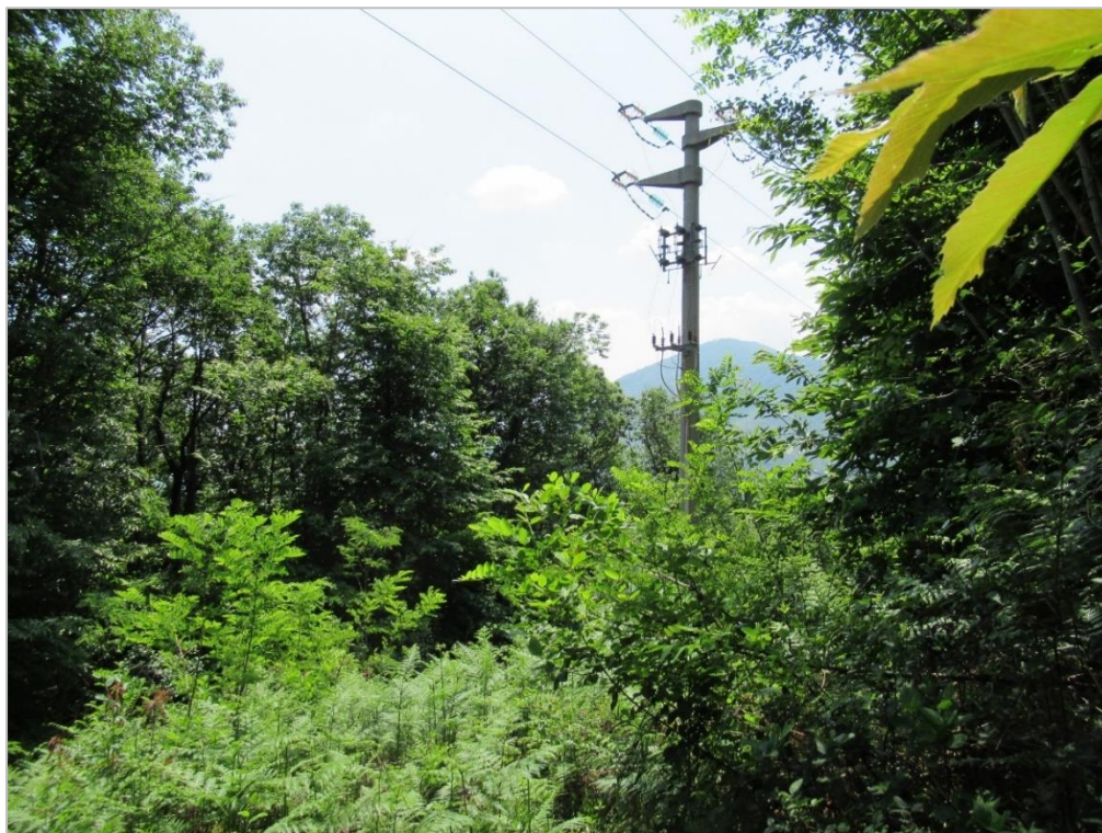
Figura 2.2.2/23 - Palo della linea a media tensione
