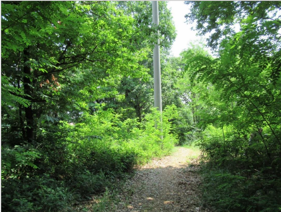
Foto 1.12 Vista della pista in corrispondenza del palo della linea a media tensione
