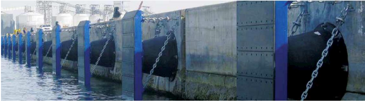
Figura 4.14 - Esempio di fender conici installati su trave di coronamento di banchina
