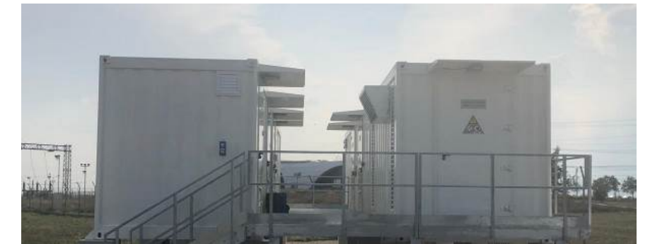
Figura 31: Esempio di installazione sistema BESS in impianto
