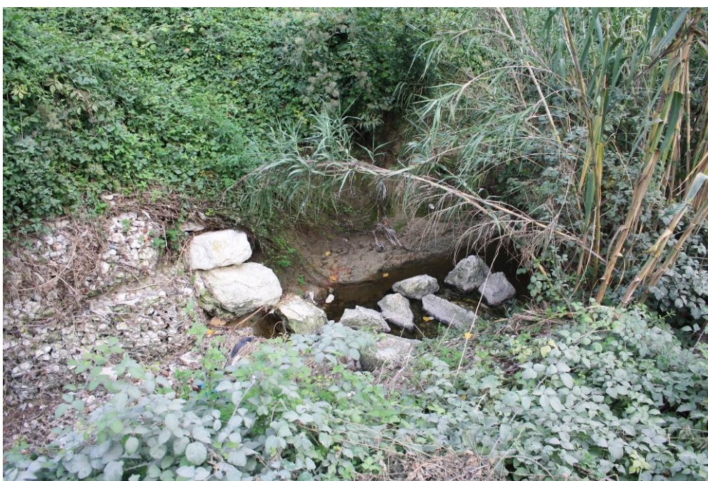
Figura 6.26 Fosso Valteja – approfondimento dell'alveo e protezione delle sponde con gabbionate - (fuori tracciato)
