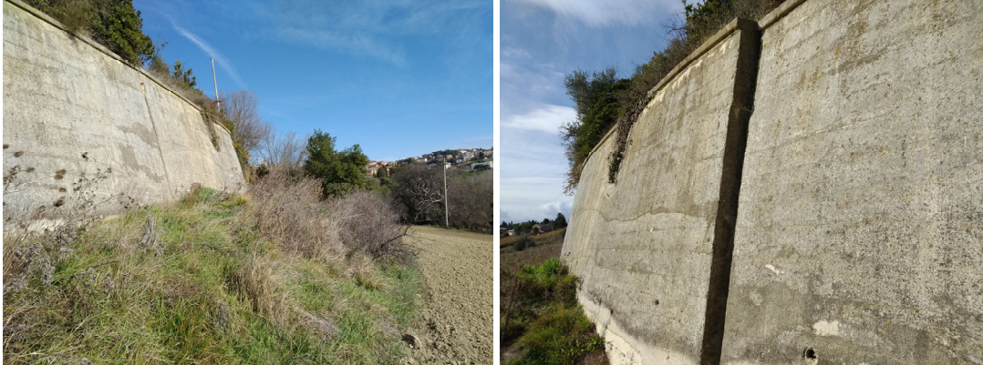
Figura 6.20 Dissesti sul muro di valle di via E. Mattei - prog. di progetto circa 4+700
