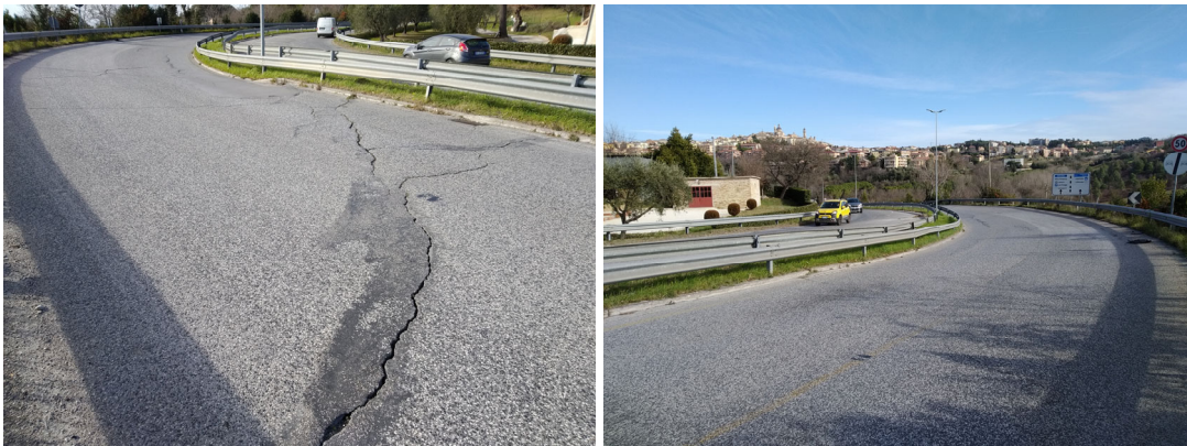
Figura 6.21 Dissesti sul fondo stradale di via E. Mattei - prog. di progetto circa 4+700
