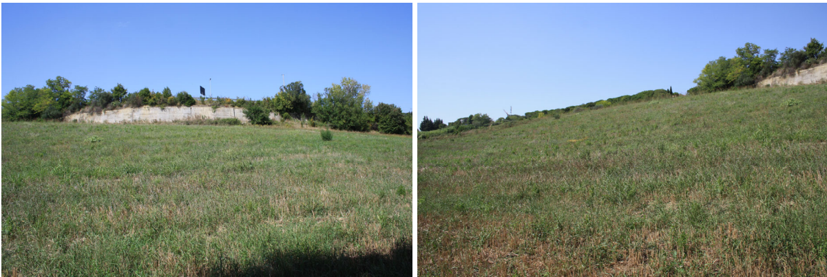
Figura 6.22 Immagini di varie angolazioni del versante a valle di via E. Mattei - prog. di progetto circa 4+700
