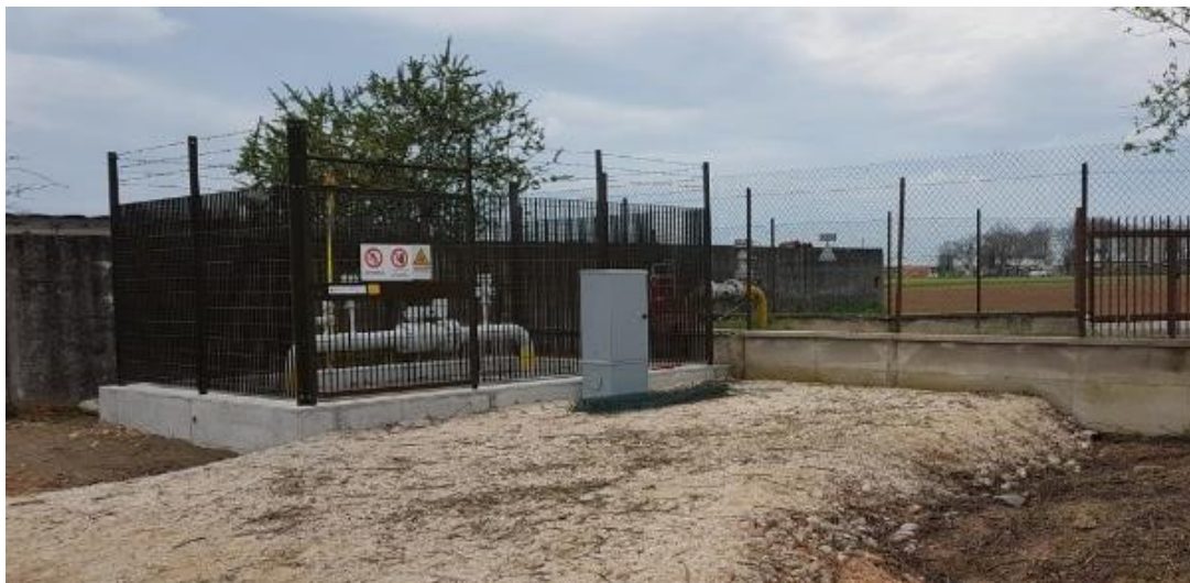
Figura 9-19 – Esempio di impianto al termine dei lavori
