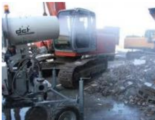
FIGURA 9: CANNONE PER L'ABBATTIMENTO DELLE POLVERI
