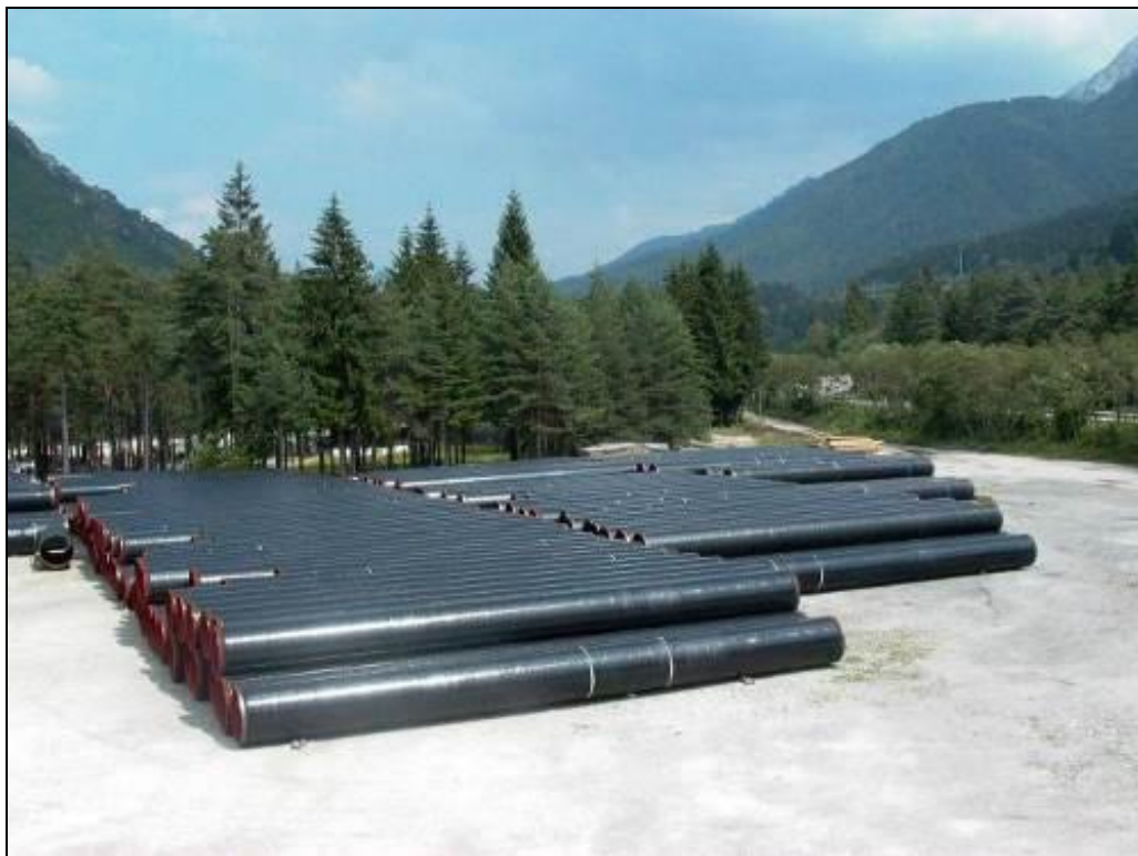
Fig. 4.4/A: Piazzola di accatastamento tubazioni
