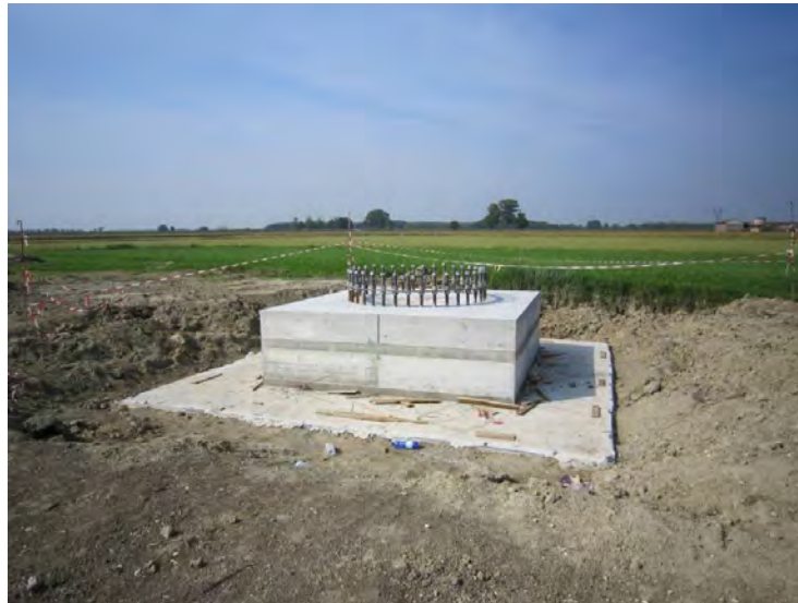
Realizzazione di fondazioni superficiali tipo plinto a monoblocco per un sostegno monostelo. Nell'immagine si può osservare una fondazione appena realizzata. Si può distinguere facilmente la flangia metallica dotata di tirafondi di raccordo con la parte in elevazione (immagine d'archivio)
