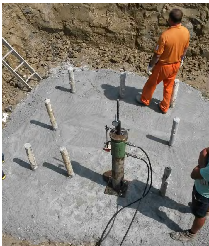
Realizzazione di micropali tipo tubfix per un sostegno a traliccio; si possono osservare i 9 micropali già realizzati ed iniettati; in questa fase, prima dell'armatura e casseratura del plinto di fondazione, si sta eseguendo una prova di tenuta del micropalo allo strappamento, al fine di verificare la corretta progettazione e realizzazione dello stesso (immagine d'archivio)
