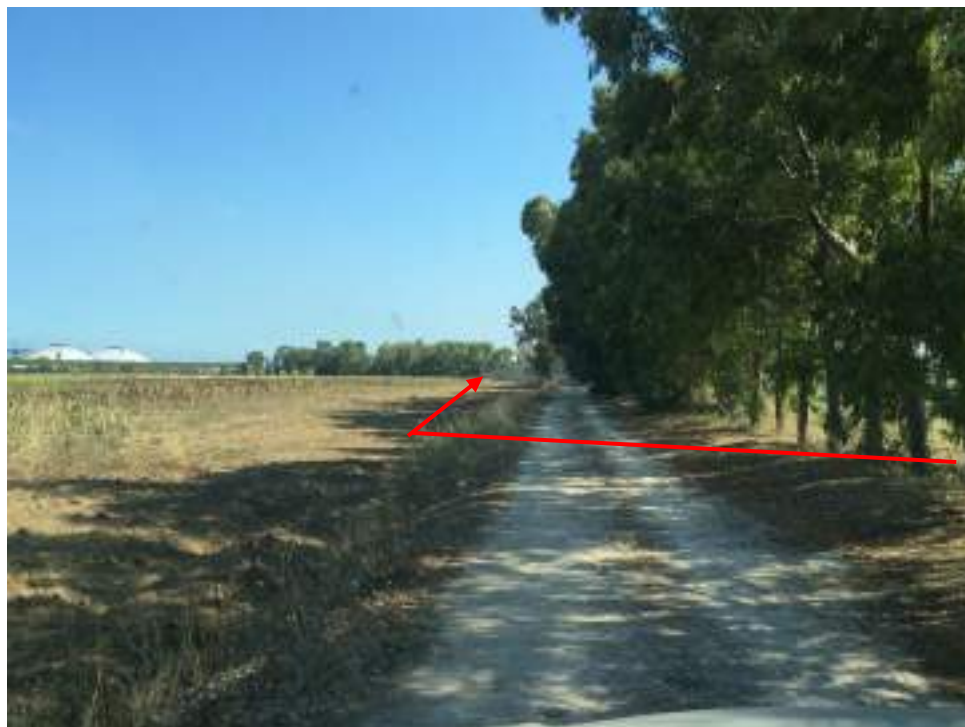
Foto 9 – Attraversamento Strada Comunale N.78 in TOC e proseguimento in parallelismo alla Strada Comunale con scavo a cielo aperto
