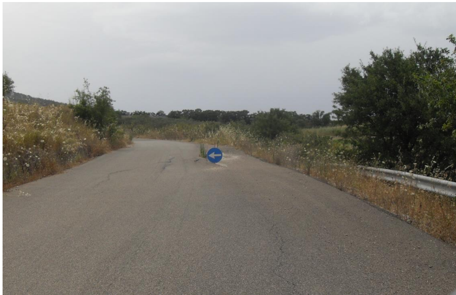
Particolare del cedimento del manto stradale con restringimento della carreggiata.
