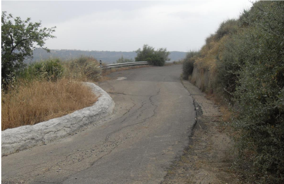
Restringimento della carreggiata per cedimento strutturale
