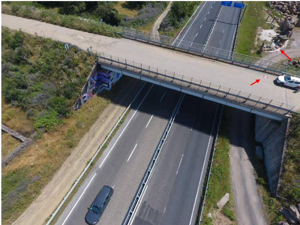
Figura 10 - esempio di immagine ad alta definizione ripresa per volo circolare di integrazione del rilievo sul viadotto al km 119 Paulilatino WBS V01. Si notino i due target posti sul cavalcavia e più in basso, a nord, lungo il confine della sede stradale con l'attività industriale di lavorazione della pietra.
