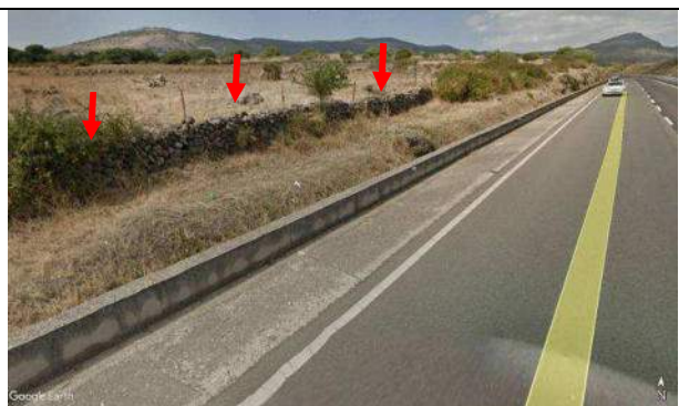
Foto 55d - Piazzola Km 140+630: panoramica - le frecce indicano il limite costituito dal muro di pietrame a secco
