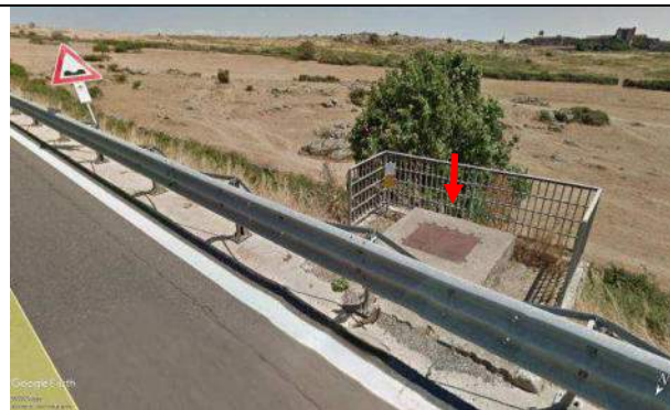
Foto 44c - S13 CS: pozzetto rete fibre ottiche sez. 36 con relativo manufatto di protezione.
