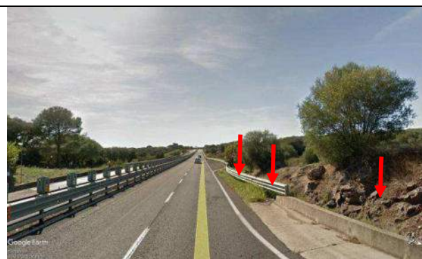
Foto 24b - Panoramica area di intervento carreggiata sud; le frecce indicano le caratteristiche della scarpata e della cunetta
