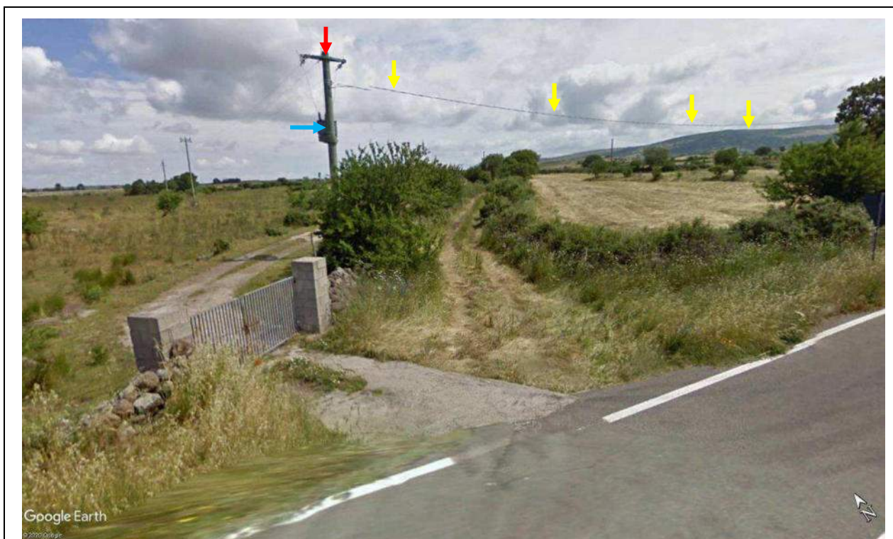
Foto 19d - Traliccio della linea Enel di Mt (freccia in rosso) con trasformatore su palo (freccia ciano) e linea elettrica di Bt in derivazione (freccie gialle)
