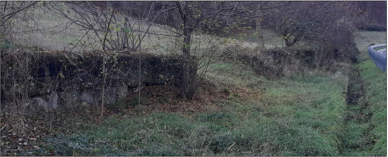
Figura 25 – Opere strutturali speciali (colonne di iniezione con trave di collegamento), tratto a Nord di Dolgo, presso Rio della Casazza
