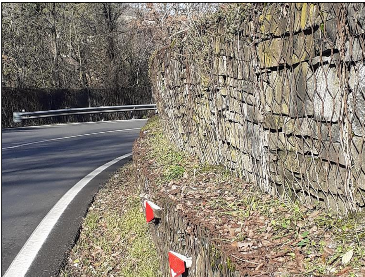
Figura 24 – Opere flessibili deformate dalla spinta del versante (muri a file di gabbioni sovrapposti) tratto tra Rio Molini e Quadrelli
