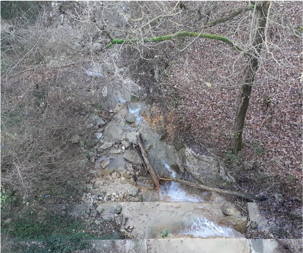
Figura 14 – Rio di San Michele, presso Castello di Montichiario: tendenza erosiva con approfondimento sino al substrato arenaceo, contrastata con la realizzazione di soglie di fondo.
