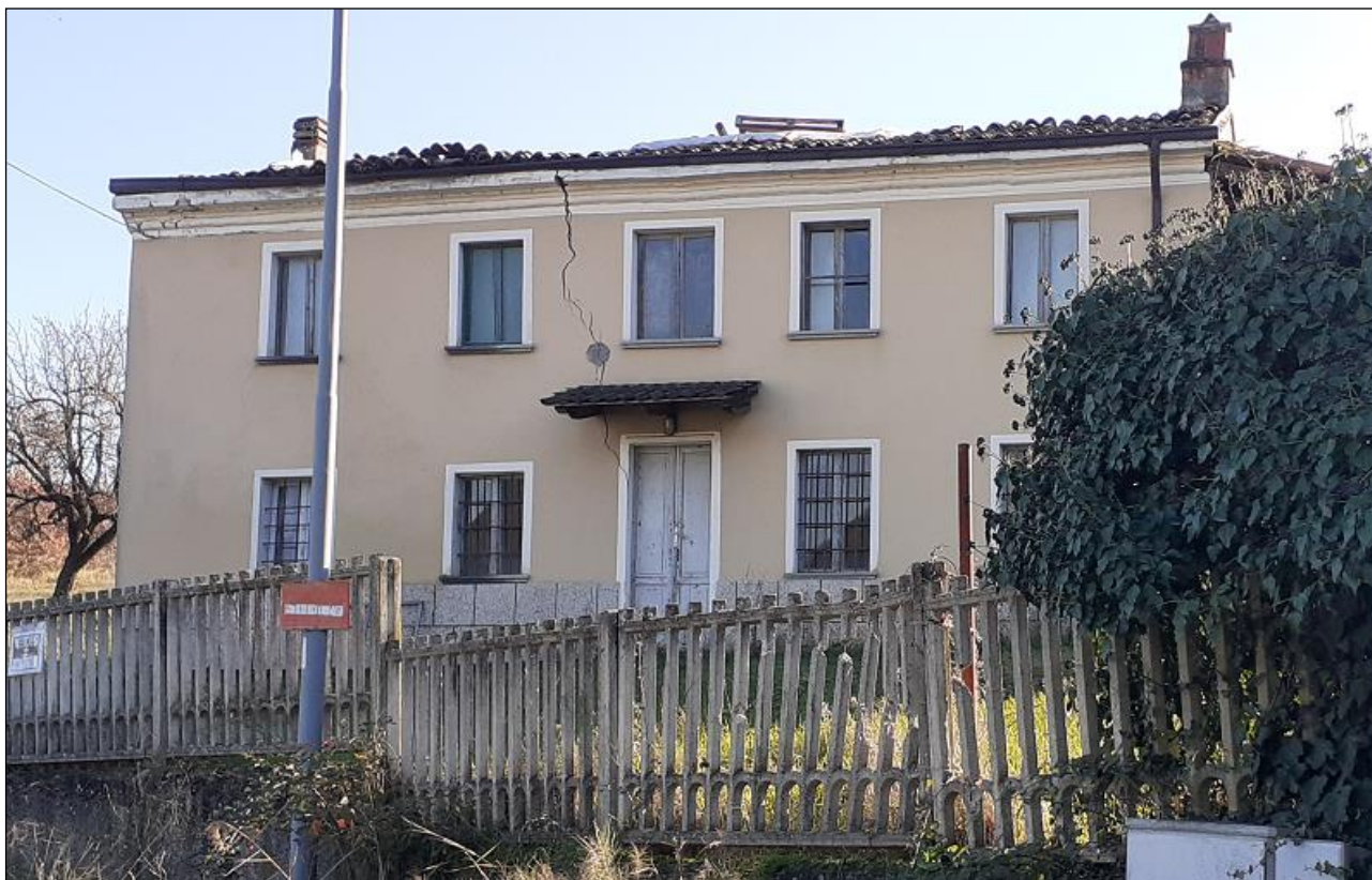
Figura 27 – Indicatore di deformazione: quadro fessurativo su edifici esistenti (località Cernusca)
