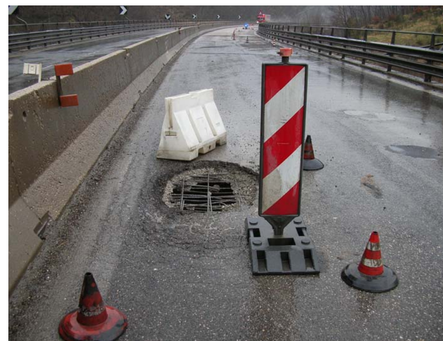
Foto 2: Esempi di degrado dello stato delle solette sulla E45
