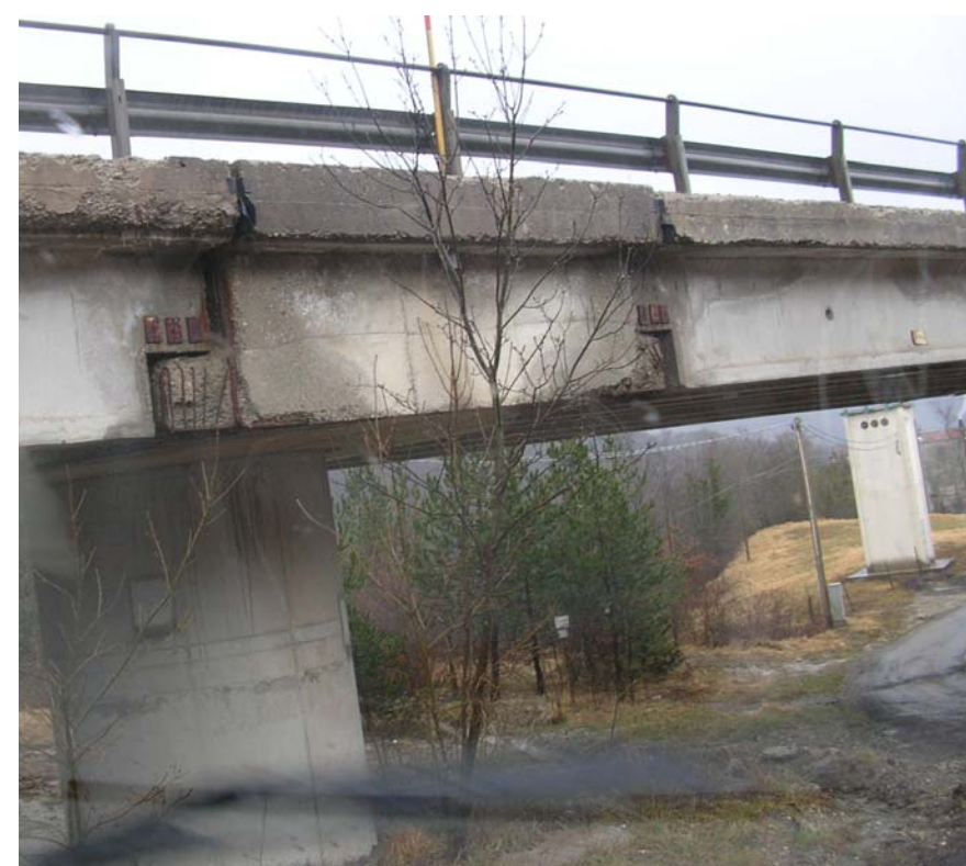
Foto 1: Esempi di degrado dello stato delle opere d'arte della E45
