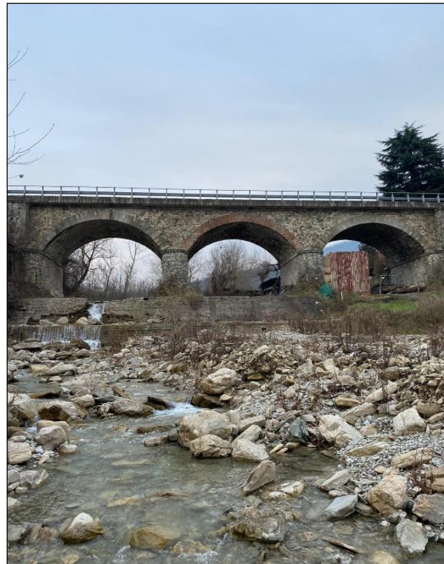
Tratto 8 - Foto 41 – Il ponte attuale sul Rio Cernusca, mantenuto al servizio della viabilità locale
