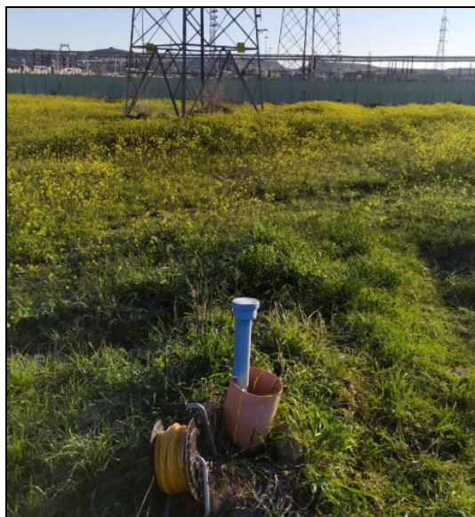
Piezometro ad ovest della centrale Terna
