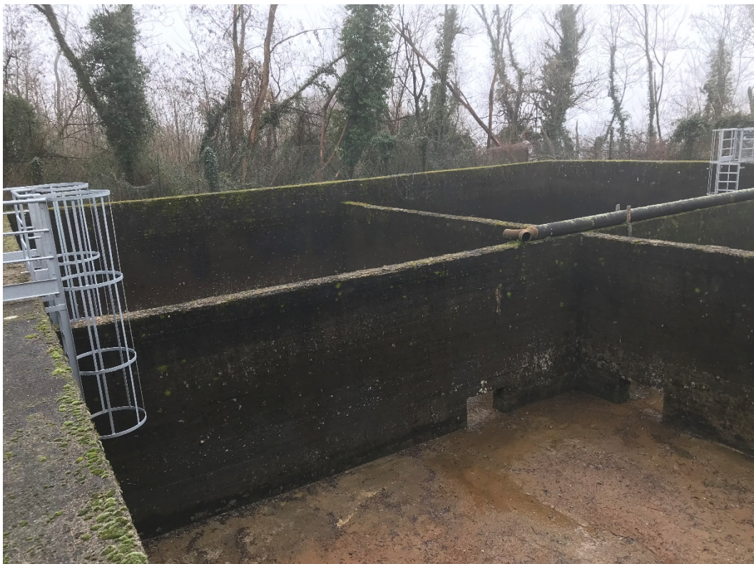
Foto – Particolare della vasca di carico a servizio della zona de La Piana di Filattiera
