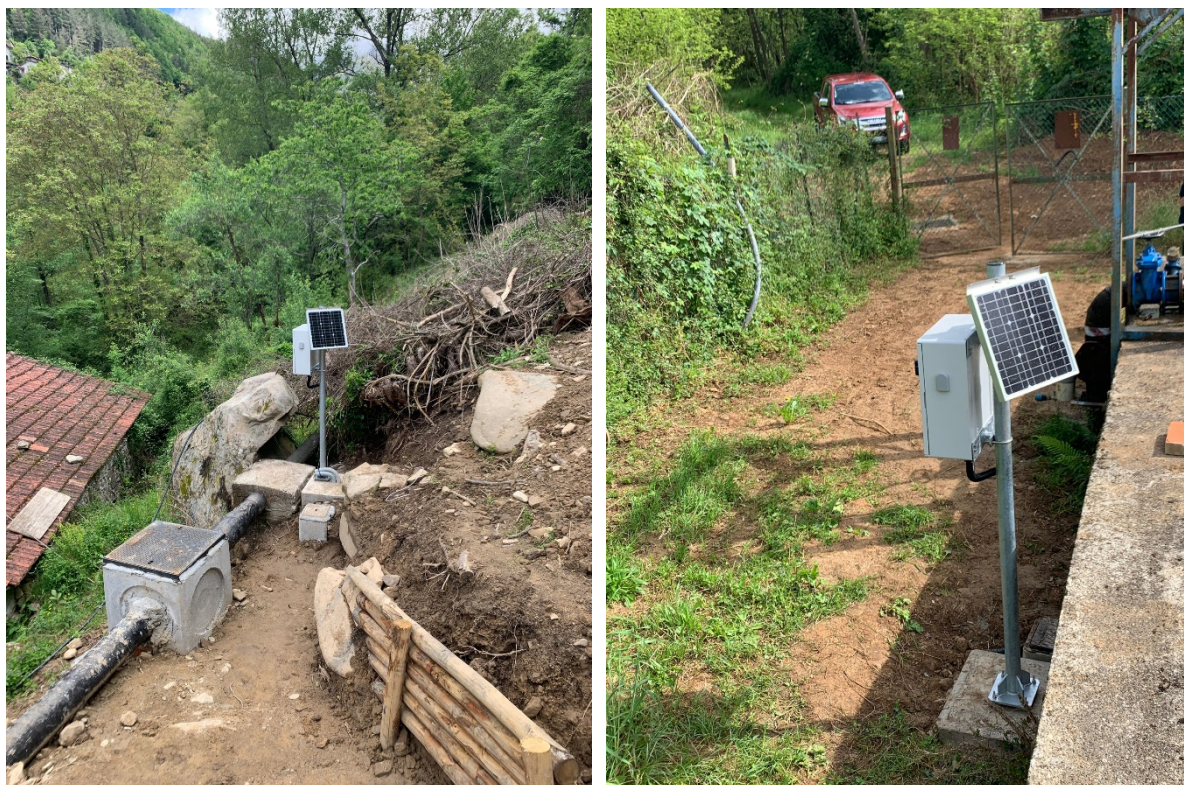
Foto – a sinistra il primo misuratore di portata a valle dell’opera di presa, in località Caprio; a destra il secondo misuratore di portata in corrispondenza delle vasche di carico
