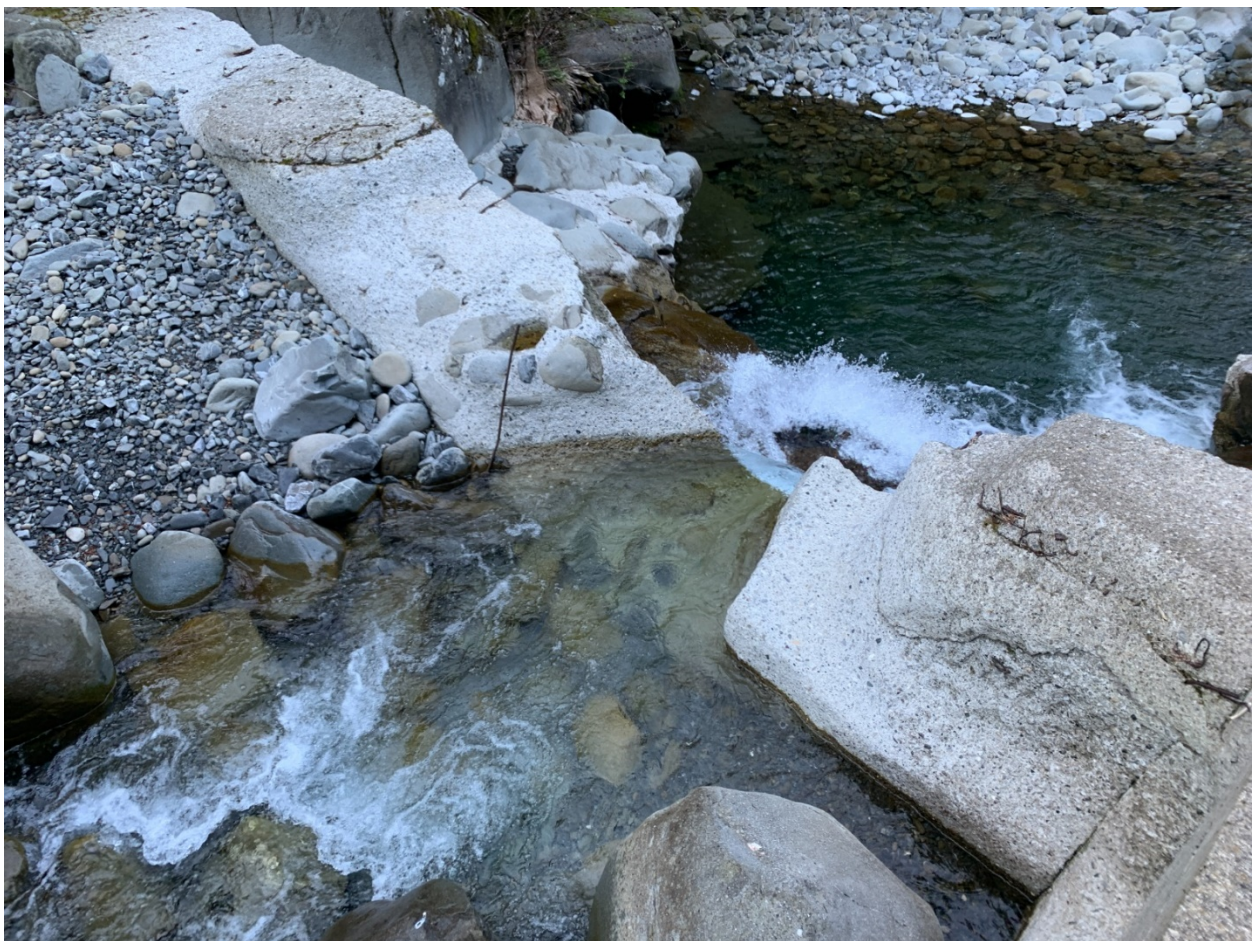
Foto – Lo sbarramento in loc. Rocca Sigillina ripreso da monte (10.08.2021). E' evidente lo stato fatiscente della gaveta della briglia
