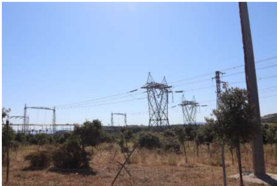
Stazione elettrica 380 kV RTN "Ittiri" esistente (vista dalla strada di accesso)
