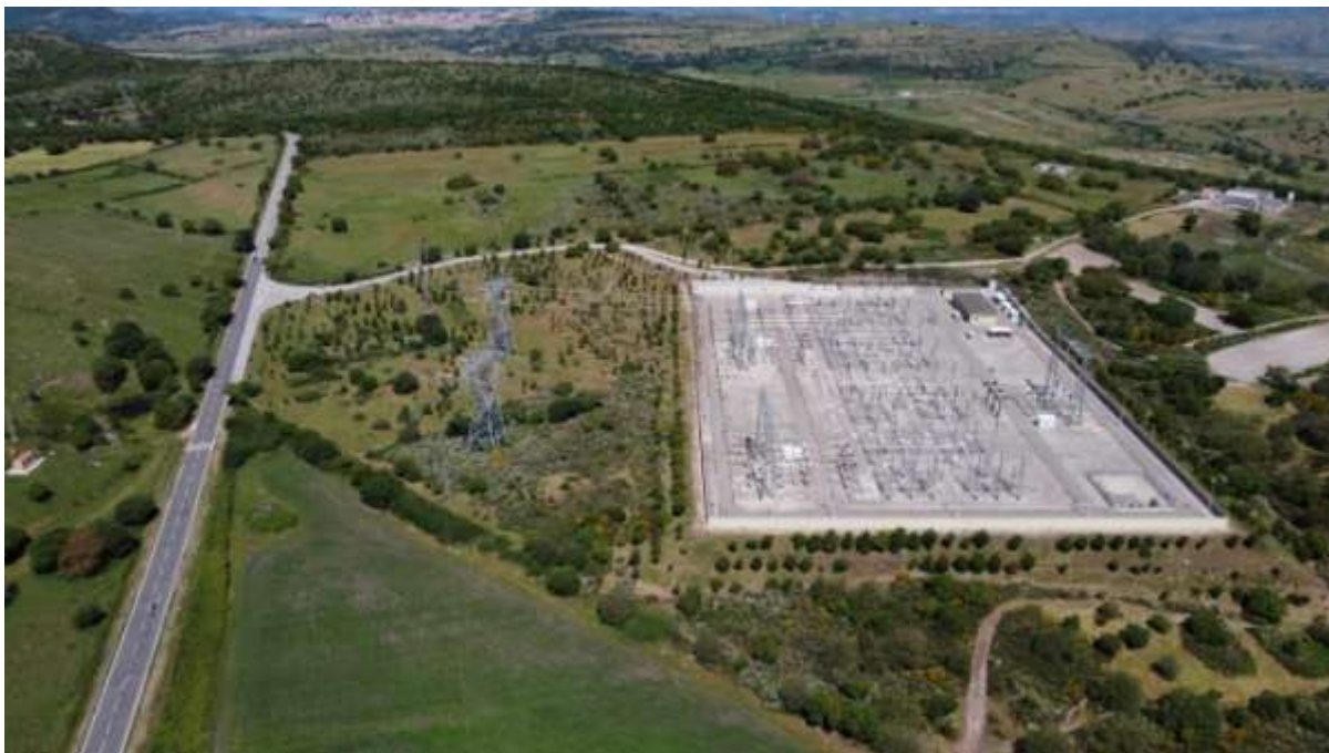
Area di ampliamento della stazione elettrica Terna e della sottostazione utente. Punto di ripresa DJI0098
