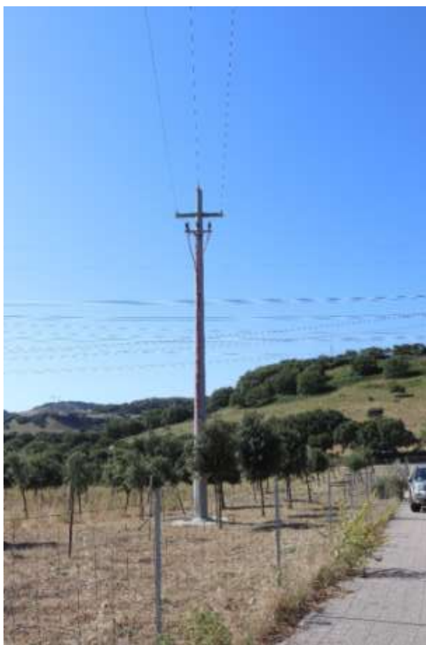
Sostegno e linea MT e, in secondo piano, linee aeree ad altissima tensione nei pressi della strada di accesso della SE RTN 380 kV "Ittiri"
