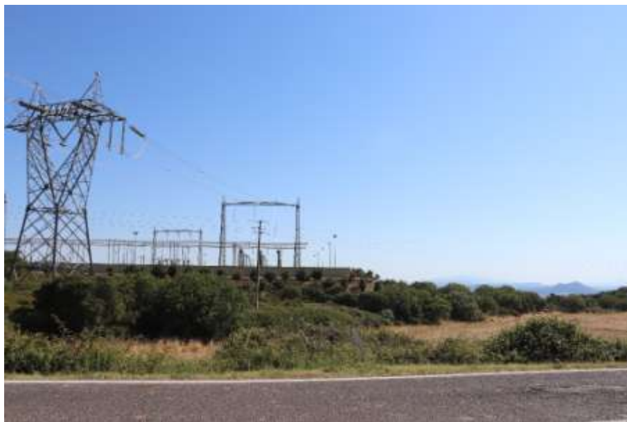
Stazione elettrica 380 kV RTN "Ittiri" esistente (vista dalla SS131bis)
