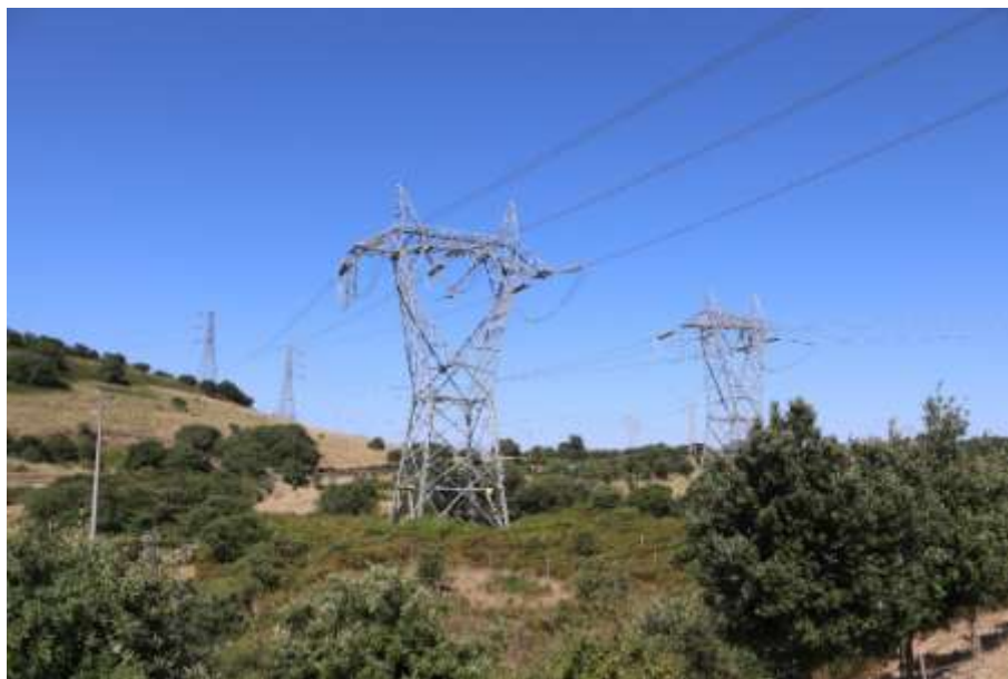
Esistenti linee elettriche ad altissima tensione nel contesto di intervento
