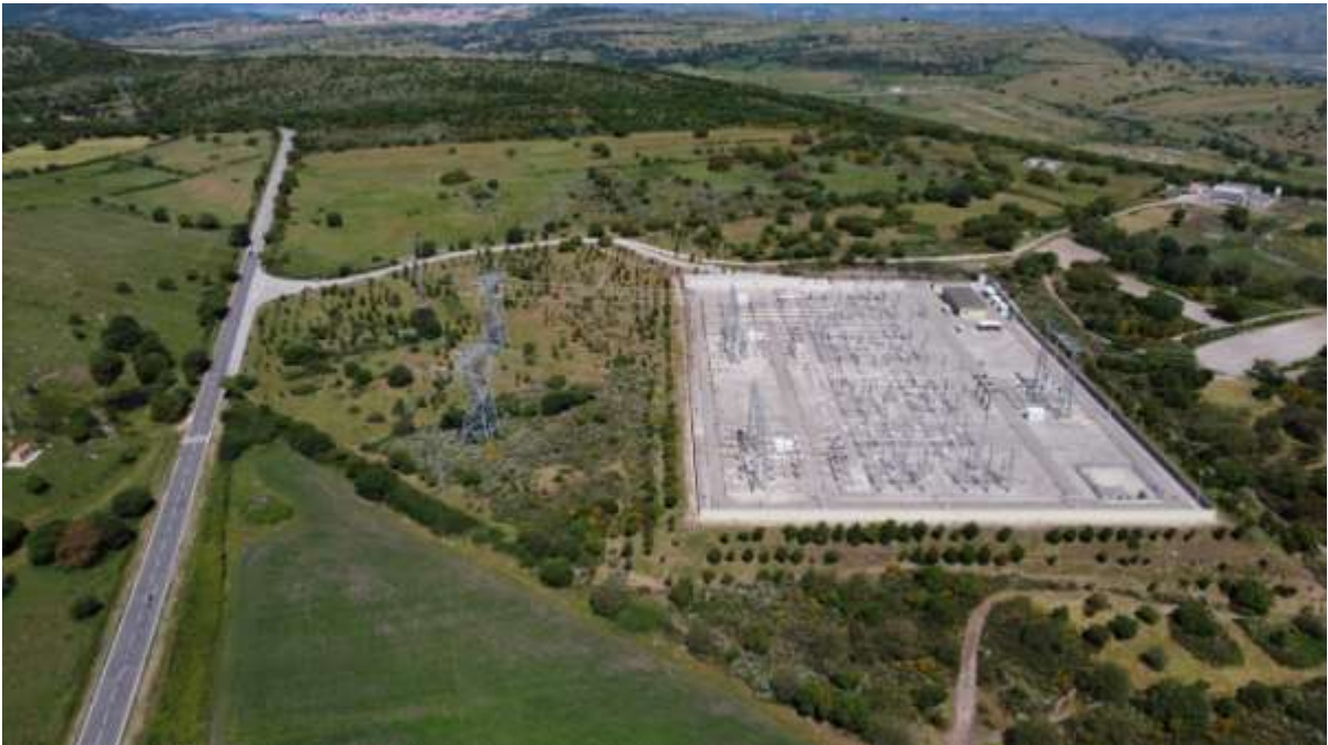
Area di ampliamento della stazione elettrica Terna e della sottostazione utente. Punto di ripresa DJI0098
