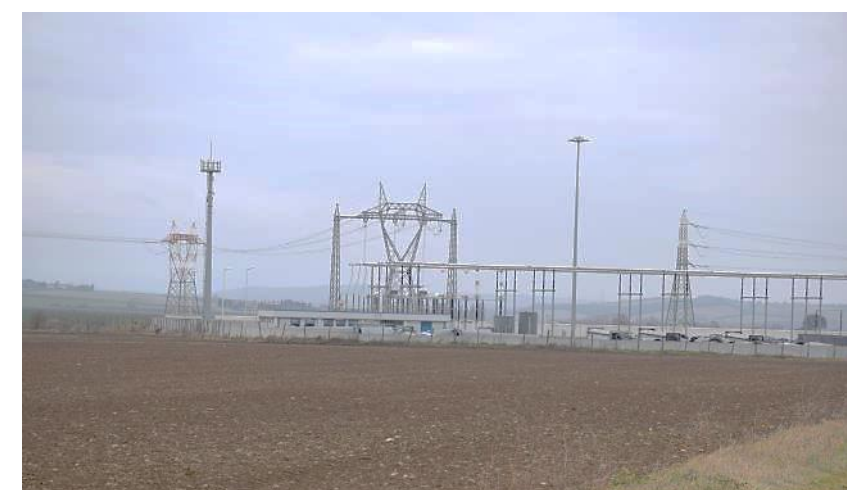
Figura 15 Immagini degli impianti e infrastrutture elettriche esistenti
