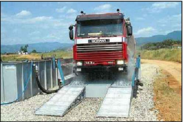
Fig. 4: Impianto lavaggio ruote
