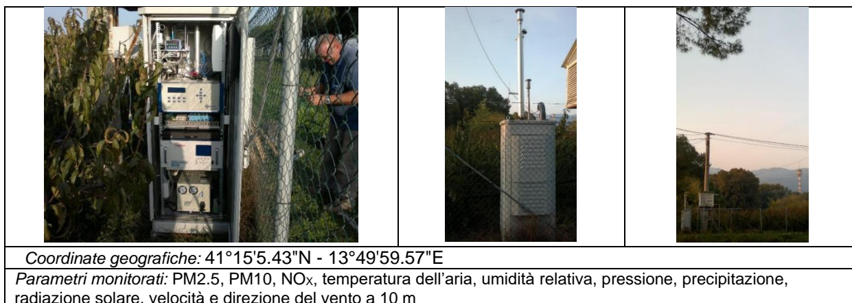
Figura 4-1 Cabina di monitoraggio
