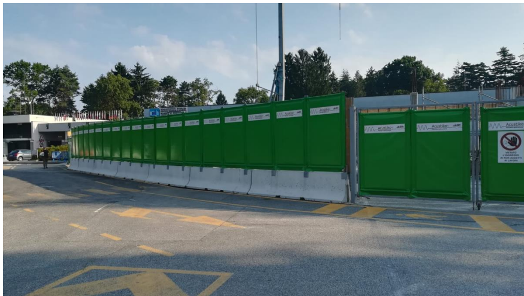
Esempio di barriera antirumore mobile
