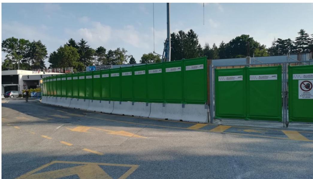
Figura 5-24: Esempio di barriera antirumore mobile
