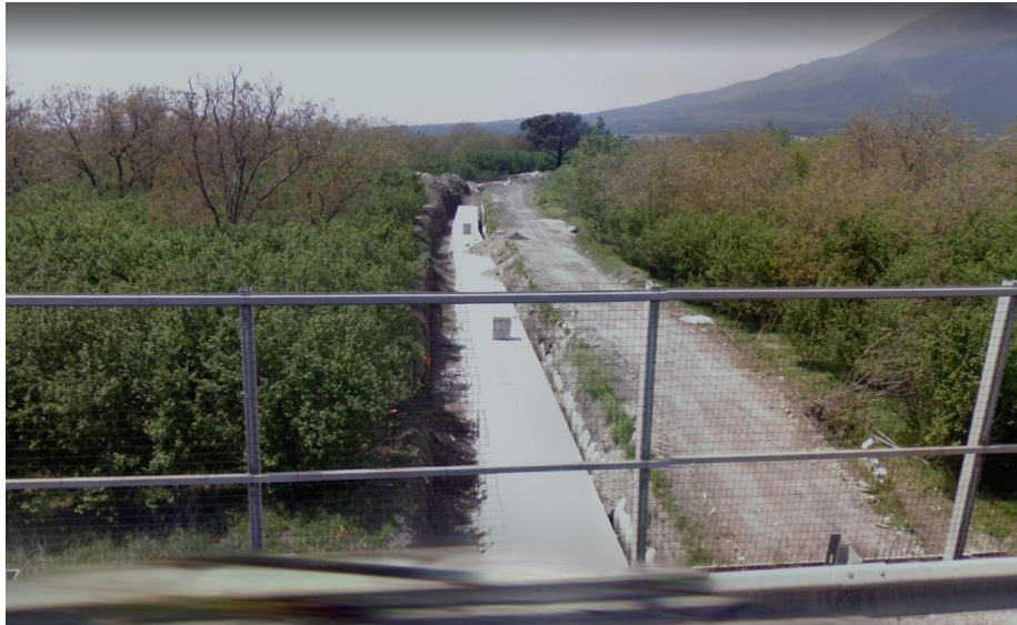
Figura 4 Intervento di manutenzione del 2007 sul canale tombato.
