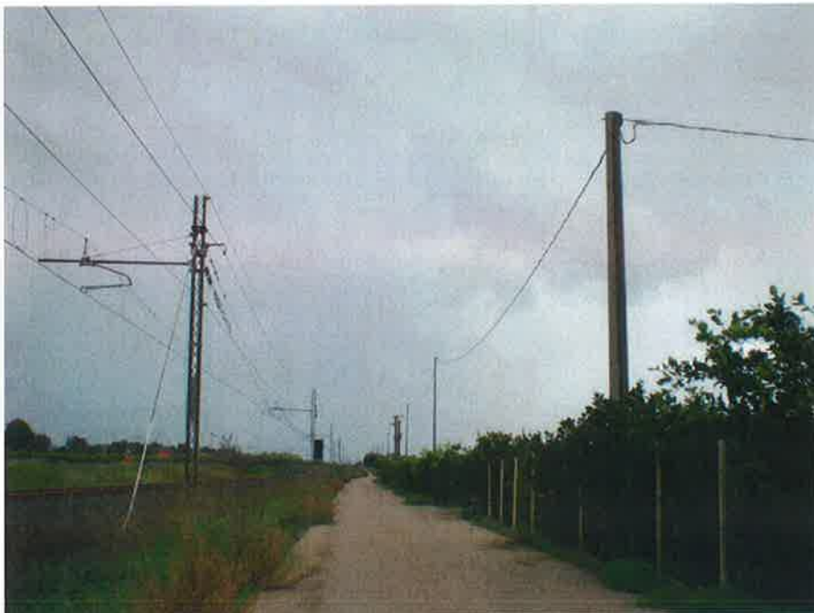
Figura 8 – Rete elettrica a sud della ferrovia
