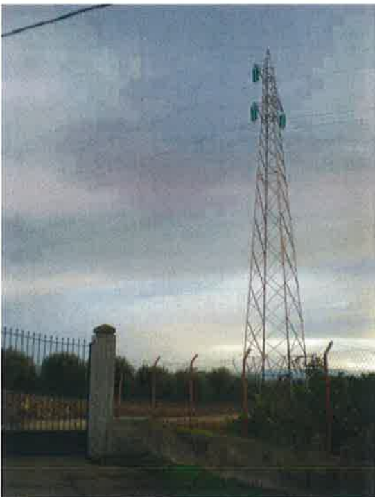
Figura 14 – Rete elettrica a sud della ferrovia
