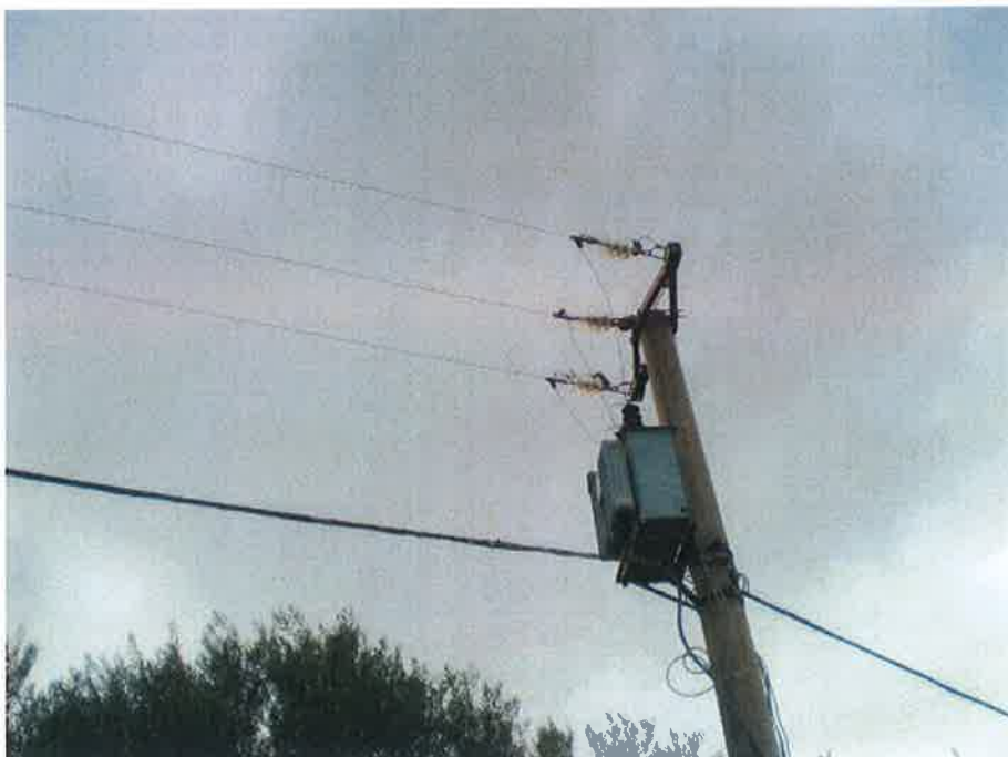
Figura 24 – Rete elettrica a sud della ferrovia
