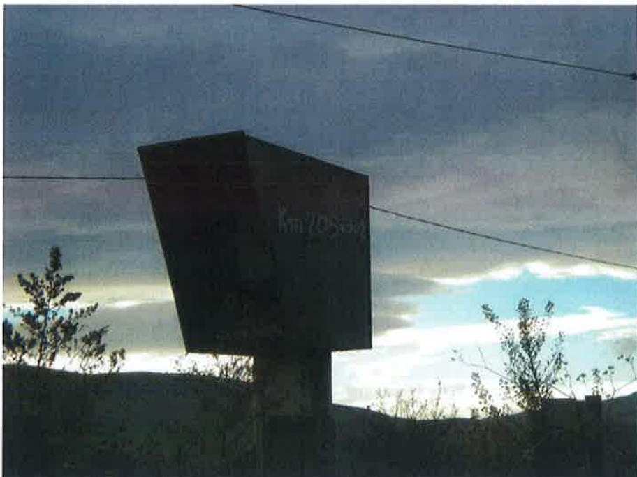
Figura 10 – Rete elettrica a sud della ferrovia
