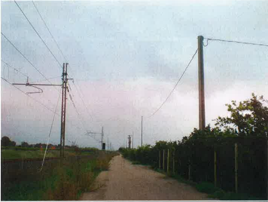
Figura 1 – Rete elettrica a sud della ferrovia
