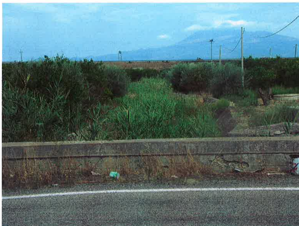
Figura 62 – Foto sopralluogo – Vallone Tirabue.
