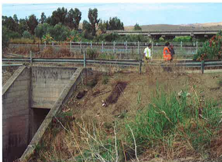
Figura 31 – Foto del sopralluogo in cui si evidenzia la notevole quota stradale del ponte a monte della ferrovia e quella esigua del tombino a valle di essa – Vallone Giudeo
