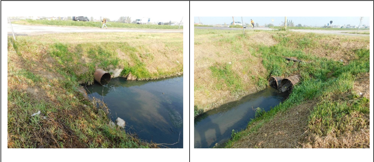
Foto 6. Interferenze tubi di scolo nel canale
