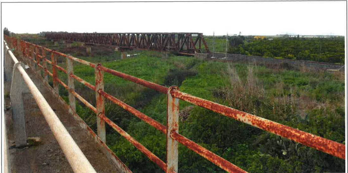
Vista dell'area destinata al cantiere per la realizzazione del viadotto sul fiume Simeto.
