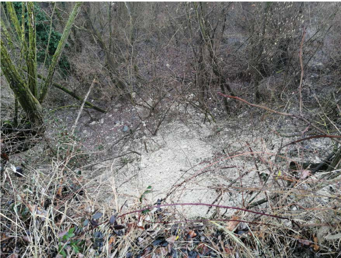
Figura 19 – Deposito detritico al piede della scarpata di frana.
