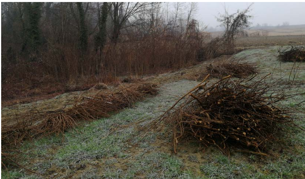
Figura 14 – Orlo della scarpata di degradazione e sprofondamento dell'area in frana.
