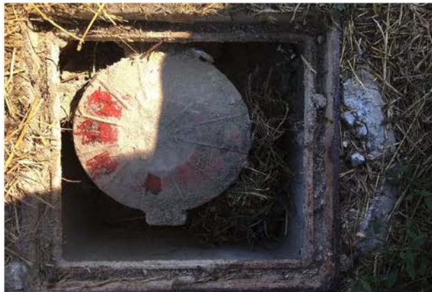
Dettaglio testa piezometro.
