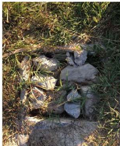
Chiusino rotto e riempito di ciottoli.
