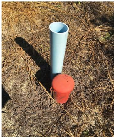
Dettaglio testa piezometro.
