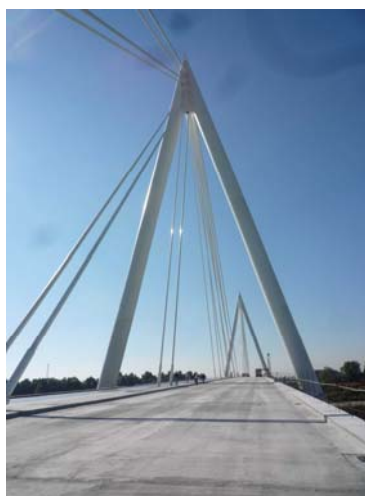
Figura 2: foto dei cantieri di costruzione del tratto a Sud – costruzione viadotto strallato sul fiume Adige
