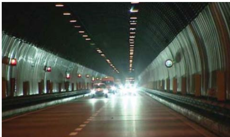
Figura 25: la galleria Piè di Castello sulla A22, con sezione stradale senza la corsia di emergenza
